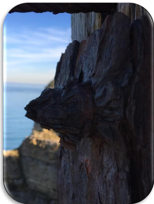
Corrosión en atmósfera C5-Línea de costa atlántica
